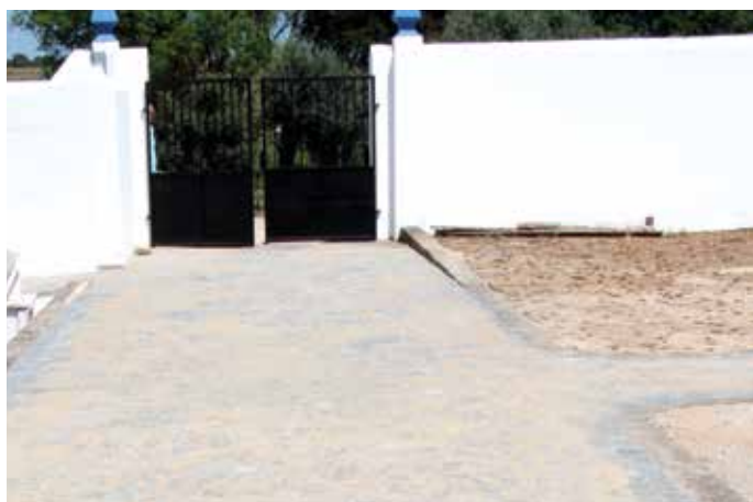
▶ CALCETAMENTO – CEMITÉRIO | OBRA REALIZADA PELA UNIÃO DE FREGUESIAS COM APOIO DA CÂMARA MUNICIPAL
