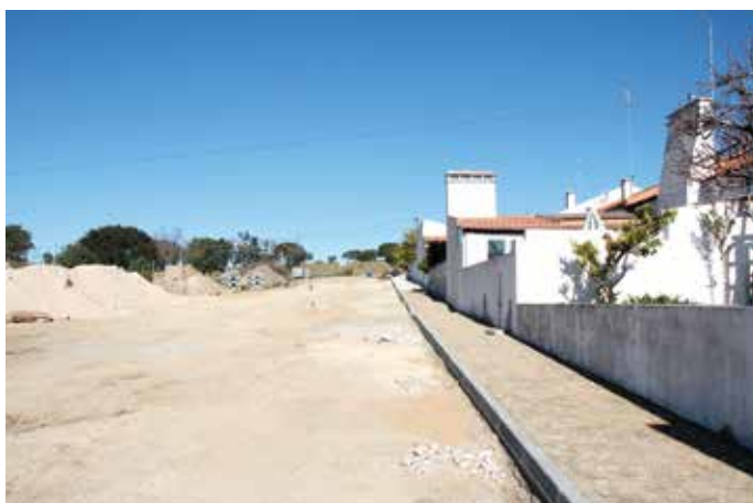
▶ CRIAÇÃO DE PASSEIO | OBRA REALIZADA PELA UNIÃO DE FREGUESIAS COM APOIO DA CÂMARA MUNICIPAL
